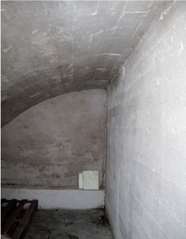
Seinien läpi tullut kosteus on jo muutamassa vuodessa tummentanut kalkkitut seinät.
