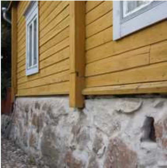
Perinteisessä hirsitalossa sokkeli voi olla jopa ulompana kuin julkisivupinta. Tuuletusraon toteuttaminen turmelisi tällaisen herkän yksityiskohdan, eikä siihen olekaan mitään tarvetta. Vanha Porvoo.
